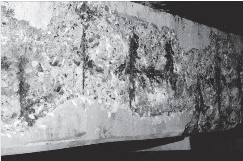
Abb. 1: Flächiger Korrosionsabtrag infolge Karbonatisierung mit Betonabplatzungen [9]
